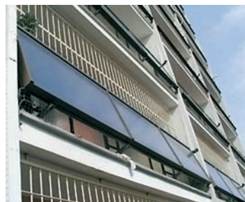
Umístění solárních panelů na lodžii objektu. (EkoWATT)
