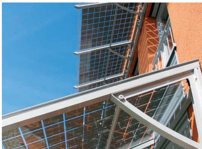
Solární kolektory jako stínící prvek nad okny a zastřešení vchodových dveří.
