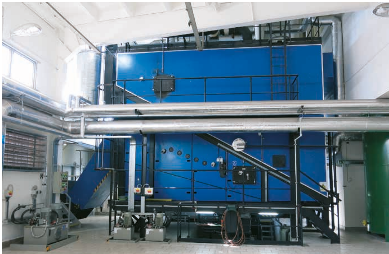
Nový kotel na spalování biomasy v Dobrušce.
