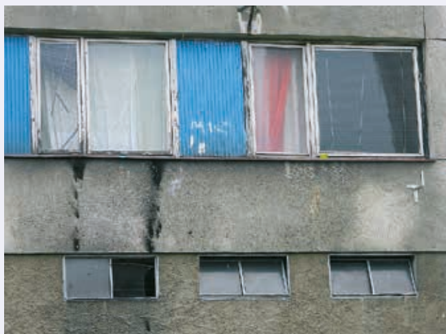
Přes okna je vidět, že byt není v dobrém stavu a na fasádě domu jsou stopy po dýmu.
