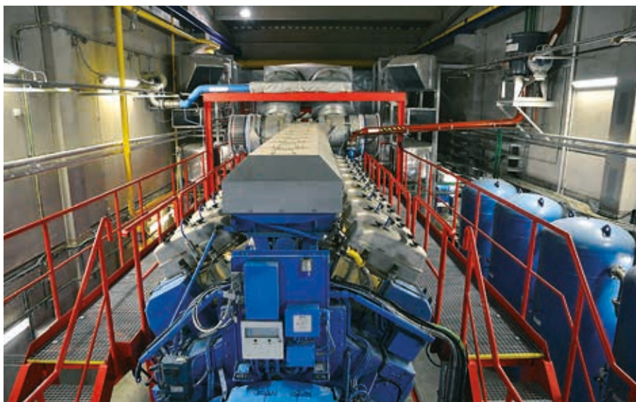
V teplárně Planá nad Lužnicí pracují největší plynové kogenerační motory u nás.
