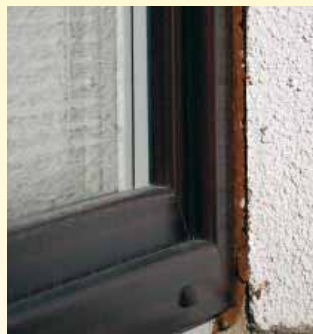
Rezavá barva montážní pěny: Důkaz totální destrukce tepelného izolantu a celkově odbyté montáže. Okno není spojené s domem.
