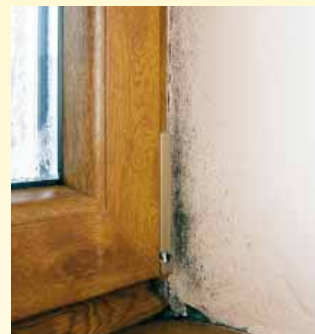
Chybějící utěsnění spáry mezi rámem a ostěním způsobilo prochlazení ostění, kondenzaci vodních par a vznik plísní.
