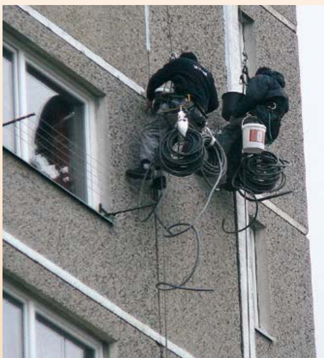
Nutná oprava – utěsnění spojů mezi panely
