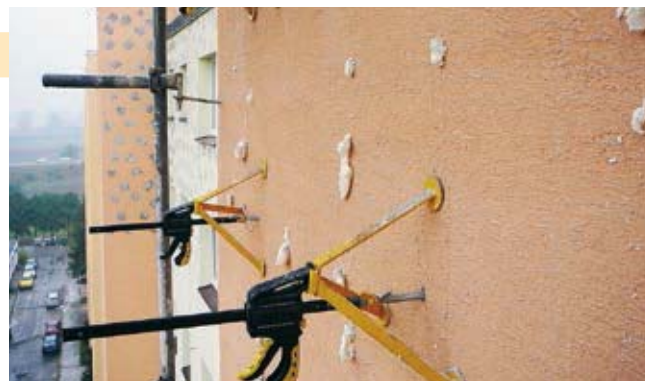
Sanace nestabilního zateplení
