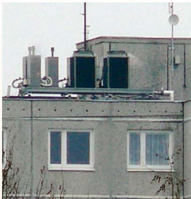
Technologie tepelných čerpadel umístěná na střeše domu
