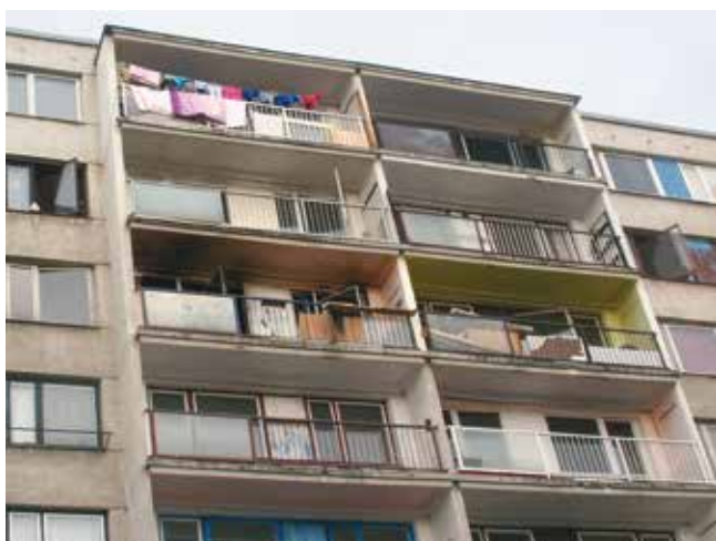
Už při příchodu k domu vzhled oken a balkonů napovídá, co nás uvnitř čeká.
