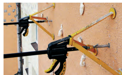
Obr.: Sanace nestabilního ETICS
