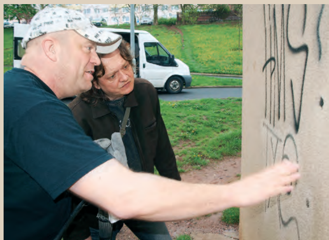
Blok 625: Černý pigment graffiti byl sice odstraněn, avšak zůstává zbytková kresba. Ta musí být přetřena novým nátěrem fasádní barvy. Tato situace by nenastala, kdyby fasáda již předtím obsahovala antigraffiti nátěr.
