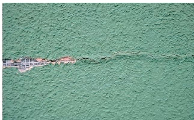
Nevhodné použití tmavého odstínu obnovovacího nátěru na stávajícím zateplení způsobující výraznou degradaci povrchového souvrství
