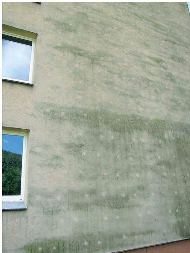
Fasáda objektu s dodatečným zateplením s výrazným napadením mikroorganismy
