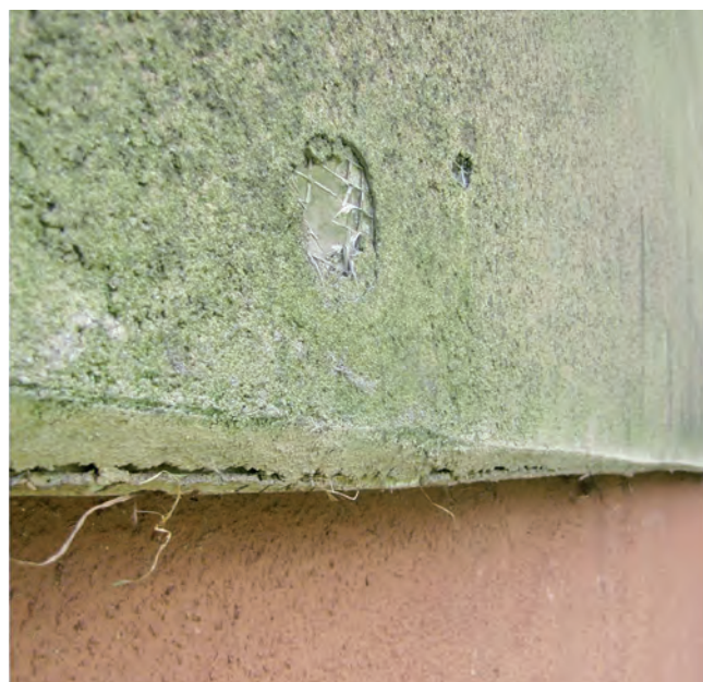
Detail fasády objektu s dodatečným zateplením s výrazným napadením mikroorganismy a navíc lokálním mechanickým poškozením
