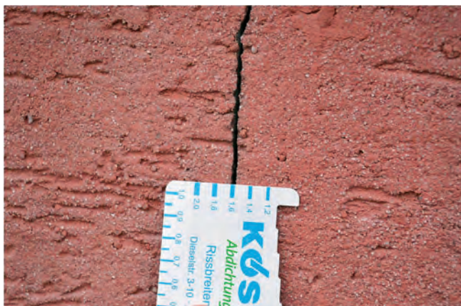
Stav dodatečného zateplení s výraznými trhlinami.
