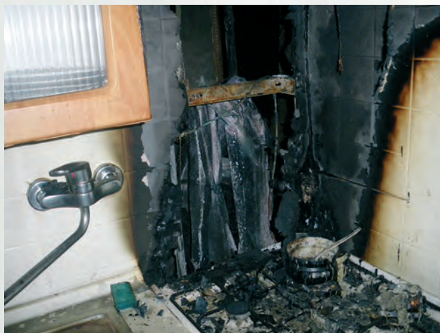
Vlastní ohnisko požáru. Tento byt patří paradoxně k těm nejméně postiženým
