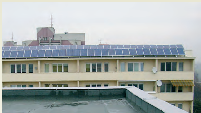
Panely fotovoltaické elektrárny na střeše našeho domu
