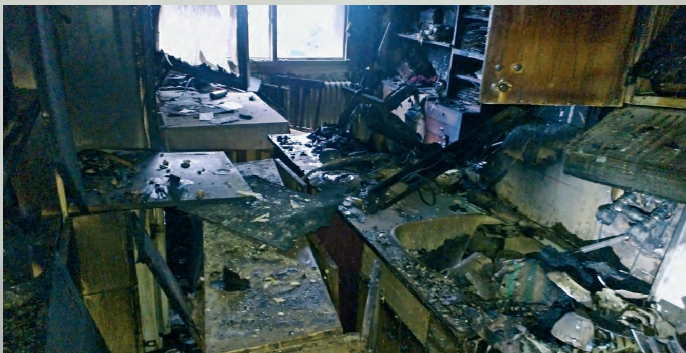
Byt, který požár poškodil nejvíce
