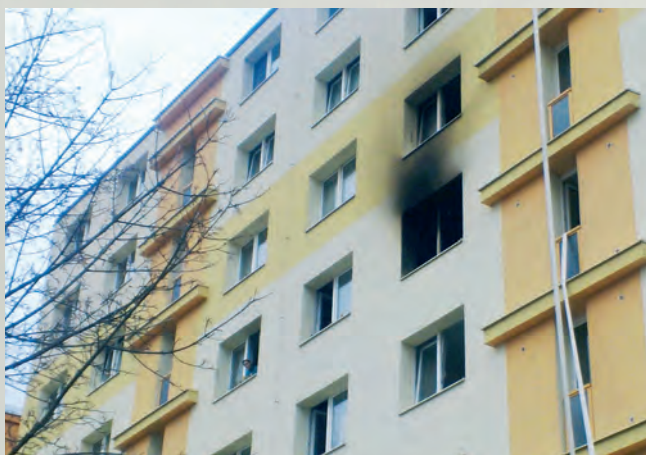
Nová fasáda je téměř netknutá, pouze očouzená u bytu, kde jeho majitel otevřel okno
