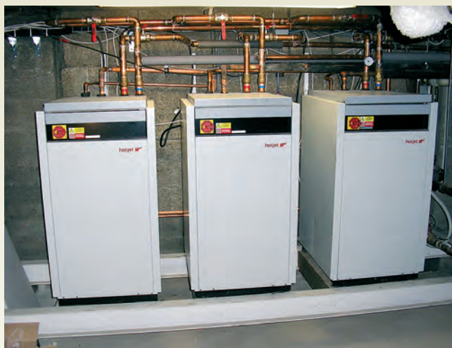
Srdce naší kotelny: tepelná čerpadla
