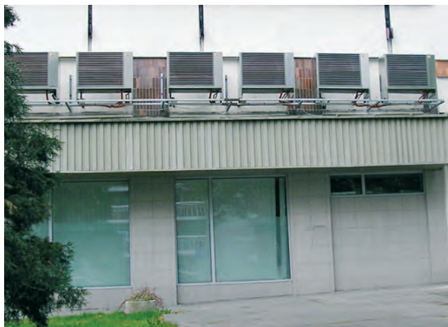
Venkovní část tepelných čerpadel
