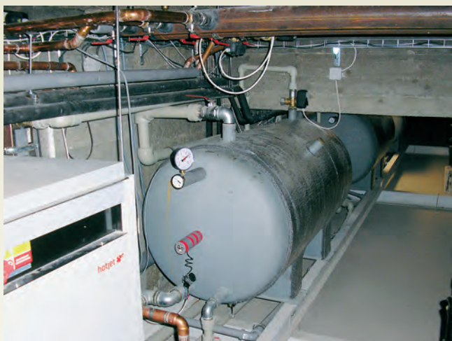
Zásobníky teplé vody
