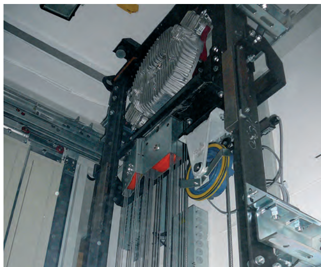
Strojovna elegantně umístěna na boku výtahové šachty
