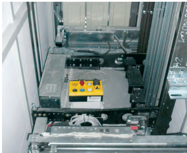
Část technického vybavení si „veze“ výtah na stropě kabiny
