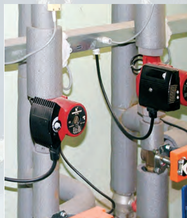
Obrázek 3: Izolace rozvodů teplé vody pouzdem PIPO ALS. Zdroj: Rockwool.
