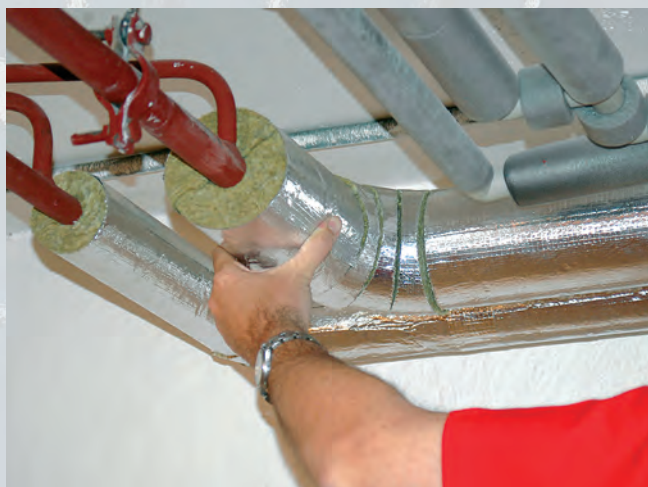
Obrázek 2: Kvalitně provedená izolace rozvodů teplé vody.
